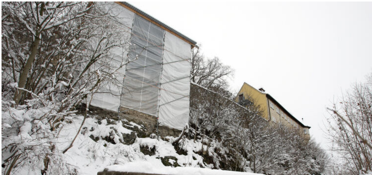
Burg Teck - Mauerfall - Aussichtsplattform eingestürzt
